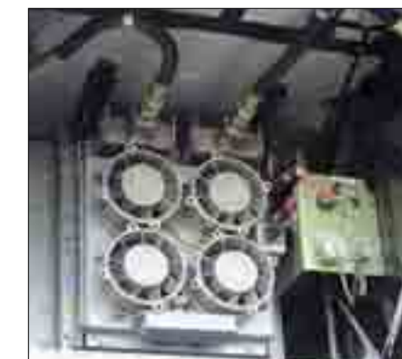
Термосифонная система охлаждения усилителя мощности РЛС
